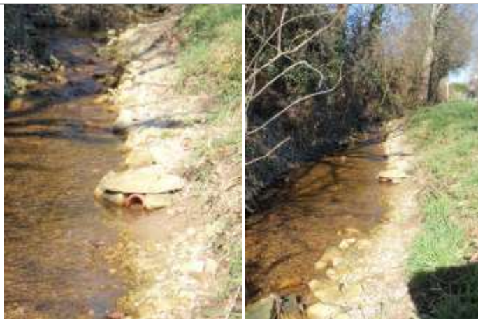
Allongement d'un drain en complément d'une opération de rehaussement du lit – Source Hardy Environnement
